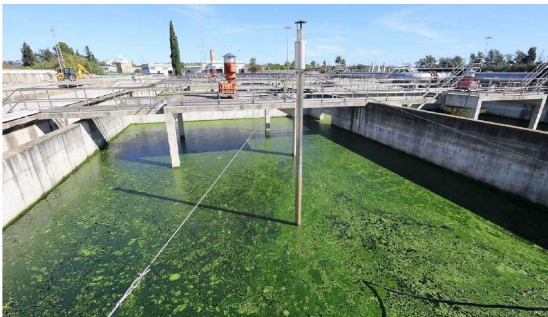
El reactor biológico de la depuradora, completamente destrozado. JUAN CARLOS TORO
