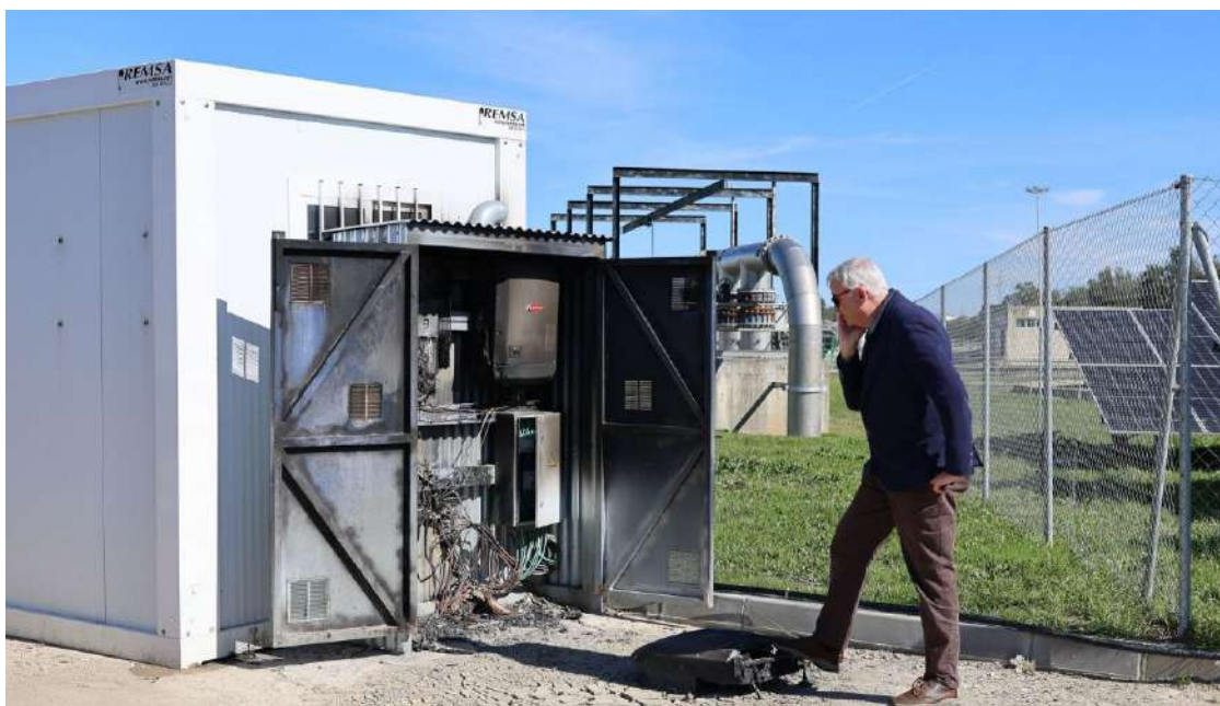
Antonio Gragera inspecciona un cuadro eléctrico, totalmente calcinado.
