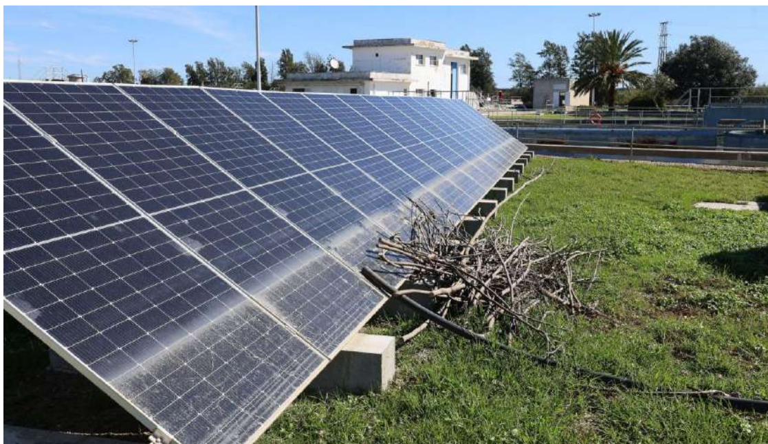
La instalación fotovoltaica, con la marca de la altura a la que llegó el agua.
